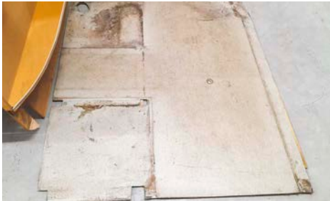
50 Jahre Arizona hinterlassen Spuren an der Dachpappe. Sie dient noch als Schnittmuster
