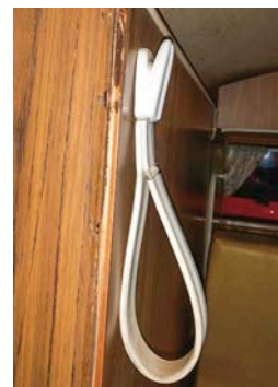
Aufgequollenes Furnier kündigt von Feuchtigkeit
